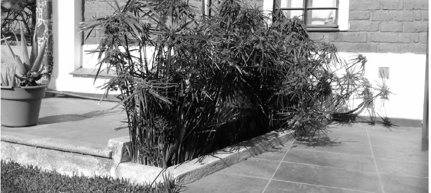
Filtro de aguas jabonosas sembrado con cola de caballo y yerba del pollo.
