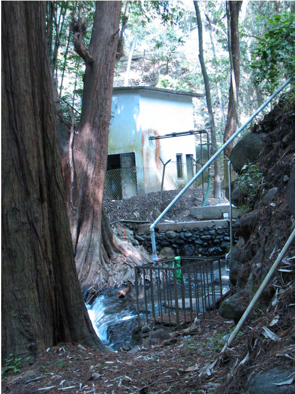
Foto 15. Instalaciones de bombeo en margen derecha de barranca Chalchihuapan, colonia Jardín Tetela.
