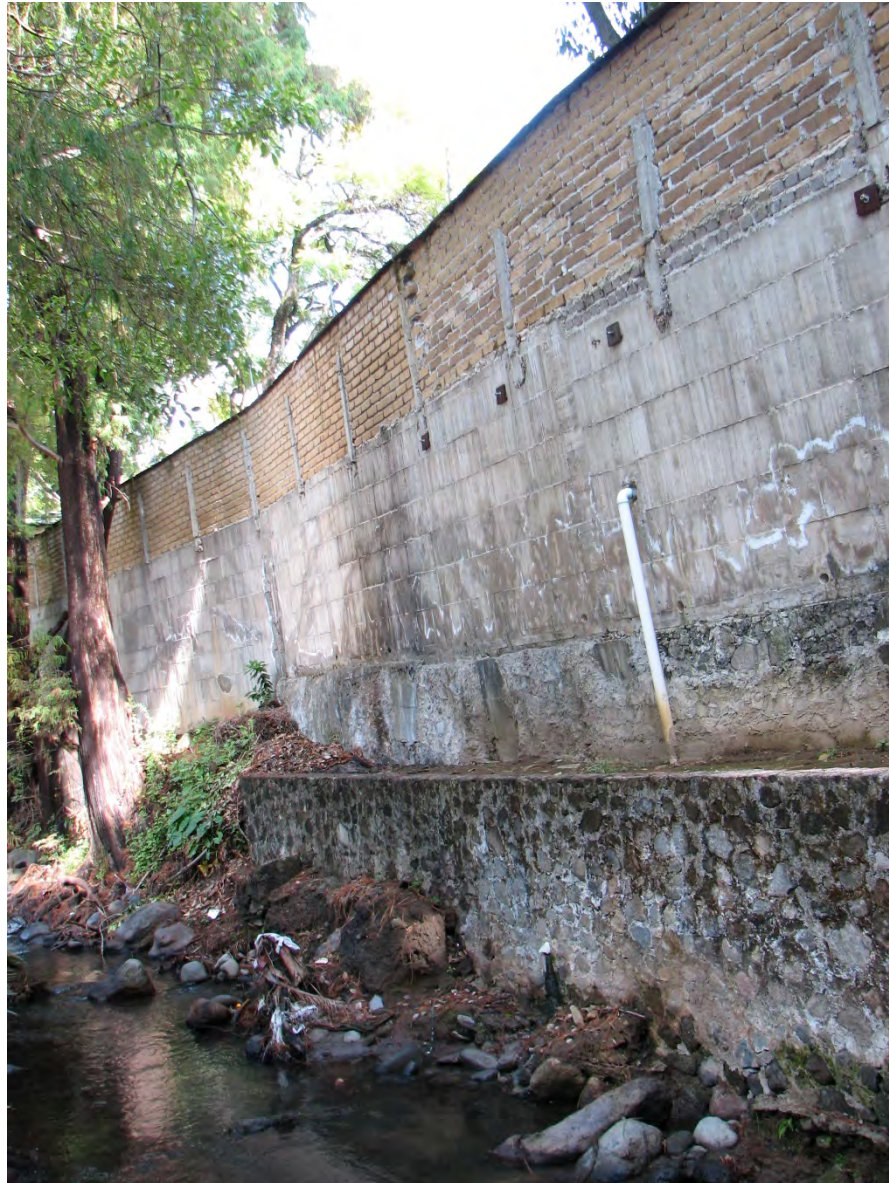
Foto 8. Invasión de zona federal por barda perimetral. Obsérvese el desplome del muro a pesar del muro de retención y defensa construido al pie del mismo. Margen izquierda de barranca Chalchihuapan.
